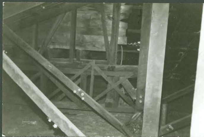
10. VIGA EN CELOSIA BAJO MUROS NO COINCIDENTES DEL MIRADOR VIGA PERPENDICULAR A CUMBRE RA.
