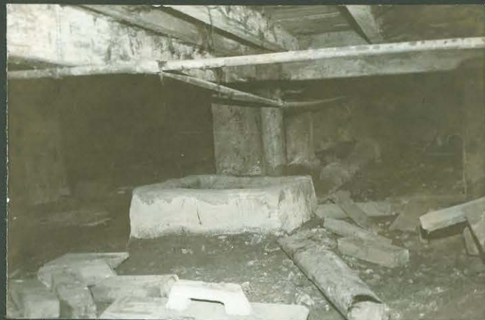
14. RED DE AGUA POTABLE Y CAMARA DE INSPECCION
