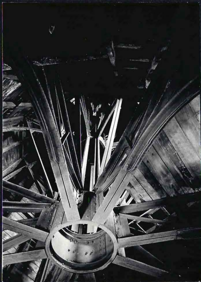
45 Estructura de la aguja.
